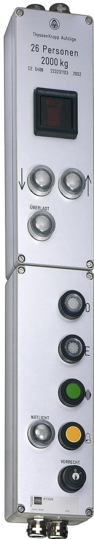
Innensteuerstelle Internal control unit
